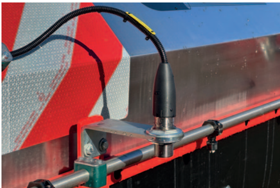
Tastautomatik an der Tunnelwaschanlage
